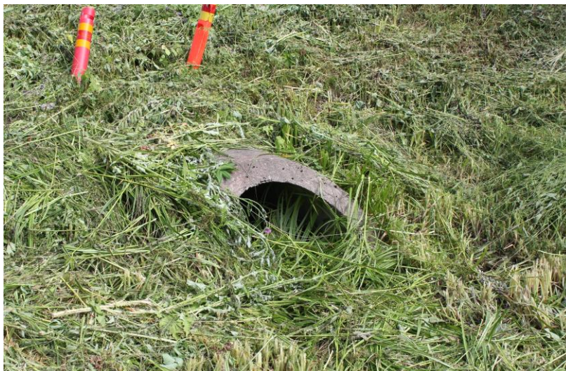
Kuva 8. Martinlähteenpuiston puron niittojätettä, mikä on osittain tukkinut siltarummun suuaukon. (Kuva: Laura Kotilainen 2015)
